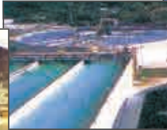
شكل (٢) محطة معالجة مياه صرف صحي
